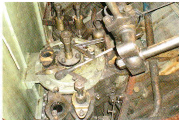
Kontroll/overhaling av påhengte pumper.
