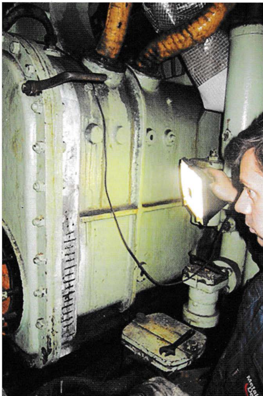
Revnet kondensator «Metalock`es». Et velkjent problem på våre gamle dampere. Saltvannets virkning gjennom hundre år kan ikke lenger oversees.
