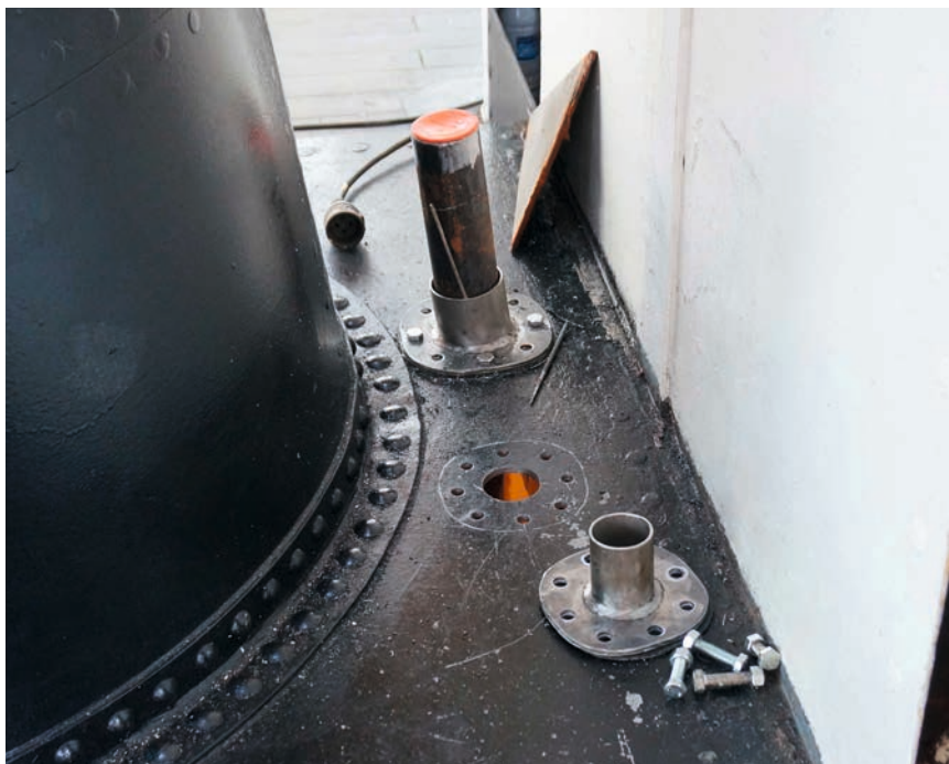
Her ser vi røropplegg for dampfløyten. Foto: Øyvind Konglevoll
