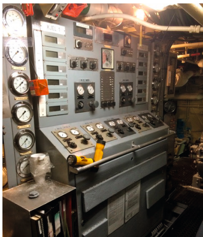
Fra et av kontrollrommene.
