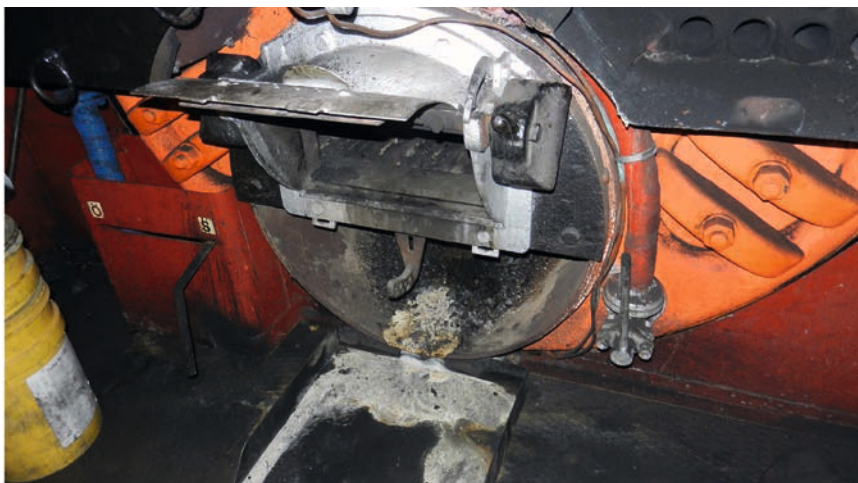
Slik ble lekkasjen oppdaget, vannet renner ut av fyrgangen.
