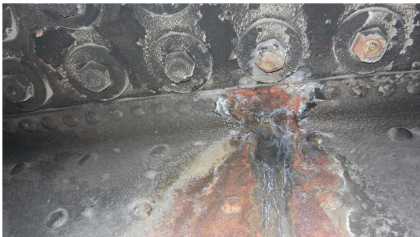
Her ser vi årsaken. Bildet er tatt inne i ildkassa, bakveggen nederst, taket øverst. I taket ser vi stagboltene som holder taket i stilling mot toppen av kjeleskallet.
