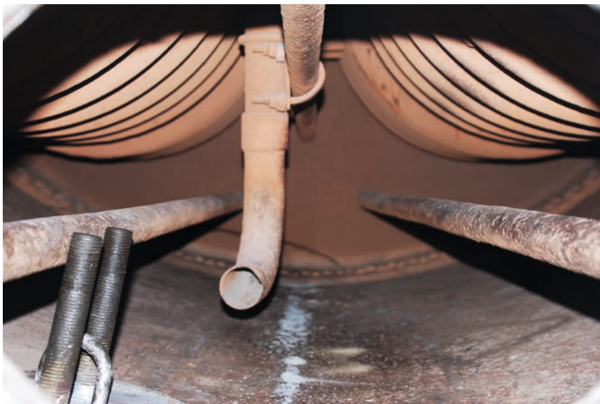
Bunnen av kjelen og undersiden av fyrgangene. Røret som stikker ned er del av en anordning for å fremme sirkulasjon av kjelevannet.
