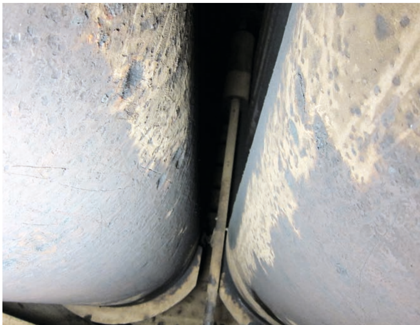
«Interiørbilde», tatt gjennom nedre mannluke mellom fyrgangene. Det later til å være noe belegg og tæring på fyrgangene.
