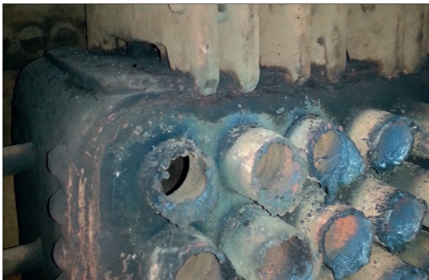
Styrbord ildkasse etter at røykrørene er brent ut. Toppen holdes på plass av bolter mellom de doble «rytterne». Her måtte det meste fornyes. Til venstre ser vi stag-boltene mot babord ildkasse.
