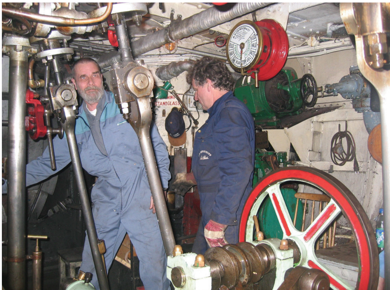
Klar for manøvrering på «Børøysund». Maskinist Kaspar Lien har høyre hånd på hoveddampventilen, mens fyrbøter Egil Jørgensen skal betjene omkastningen, det store hjulet til høyre. På maskintelegrafene ser vi at det er gitt beskjed om «stopp». Foto: Norsk Veteranskipsklub
