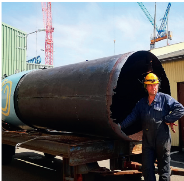
Fra denne siden ser jo den gamle skorsteinen bra ut. På motsatt side er den nesten gjennomslittig.
